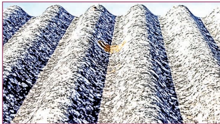
Amianto en un tejado
