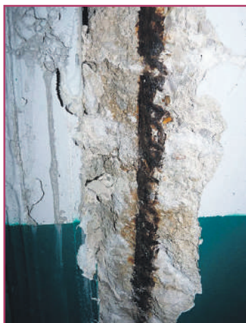
Corrosión en los pilares.
