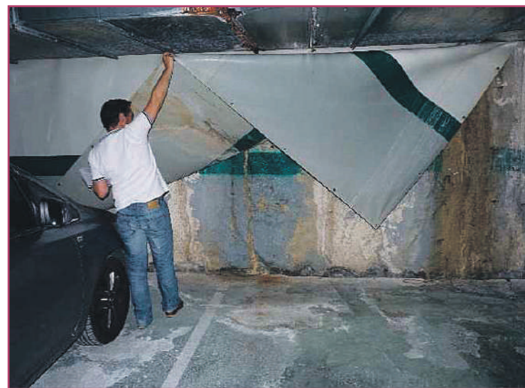
Problema de filtraciones camufladas con lonas.
