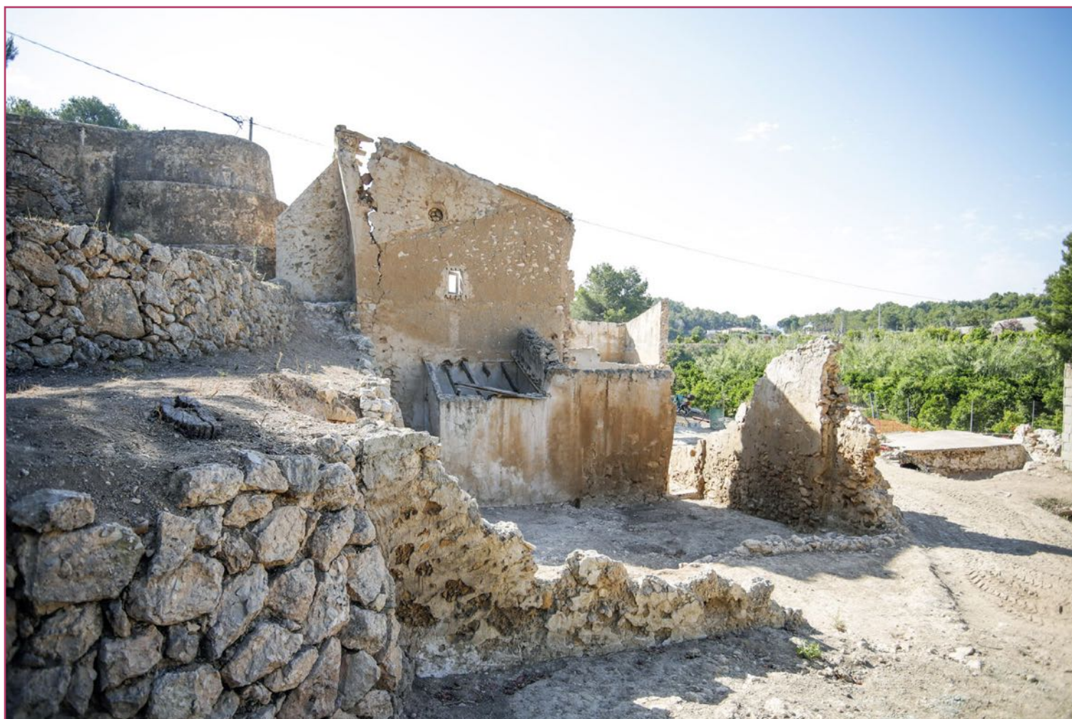
Estado previo a la intervención municipal.
