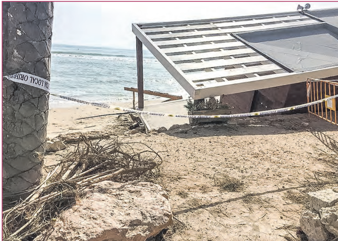
El nuevo mobiliario ha sido destrozado por la tormenta.
