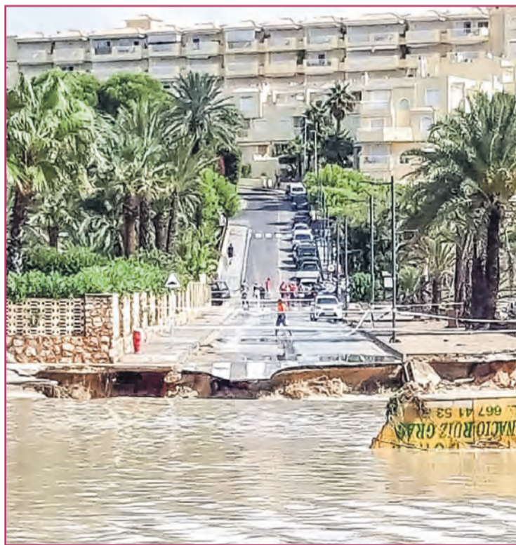
Rotura de infraestructuras causada por la tormenta.
