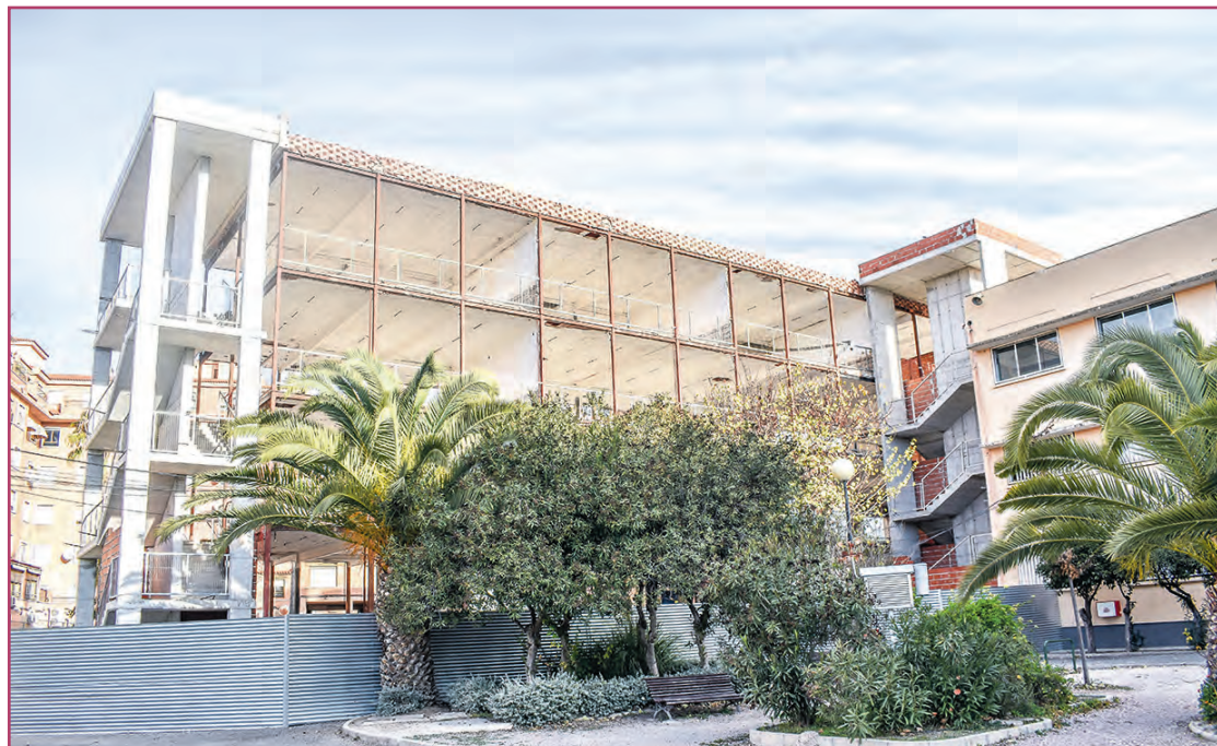
Parte lateral del instituto en la que se encontraron los fallos estructurales.
