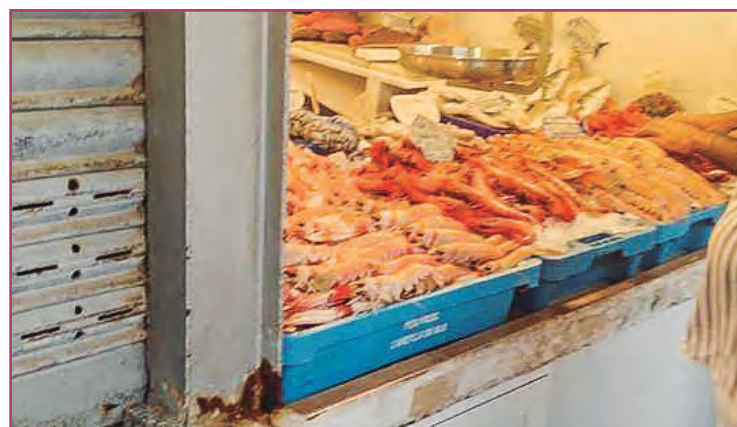
Detalle del mal estado de los puestos de la Lonja de Santa Pola.
