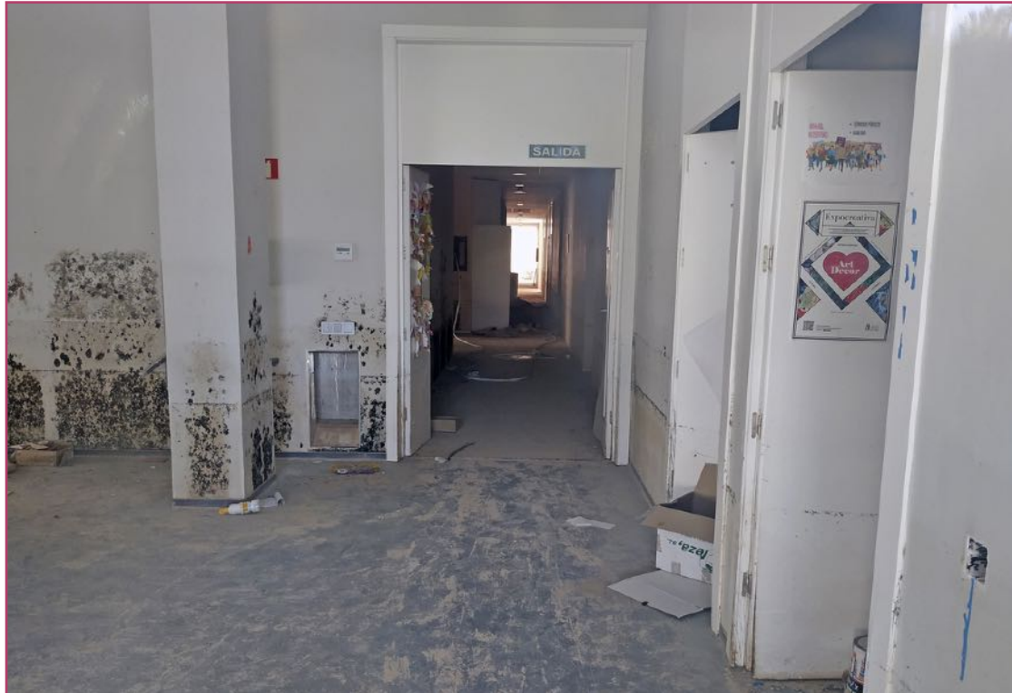
Las instalaciones del Palmaral están destrozadas.
