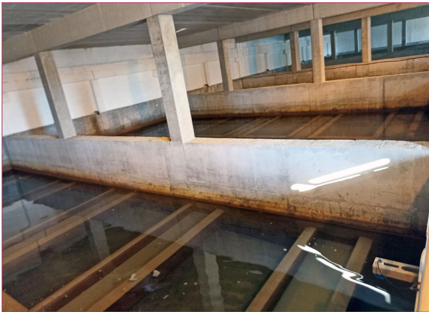
Piscinas donde se almacena el agua recién captada del mar.
