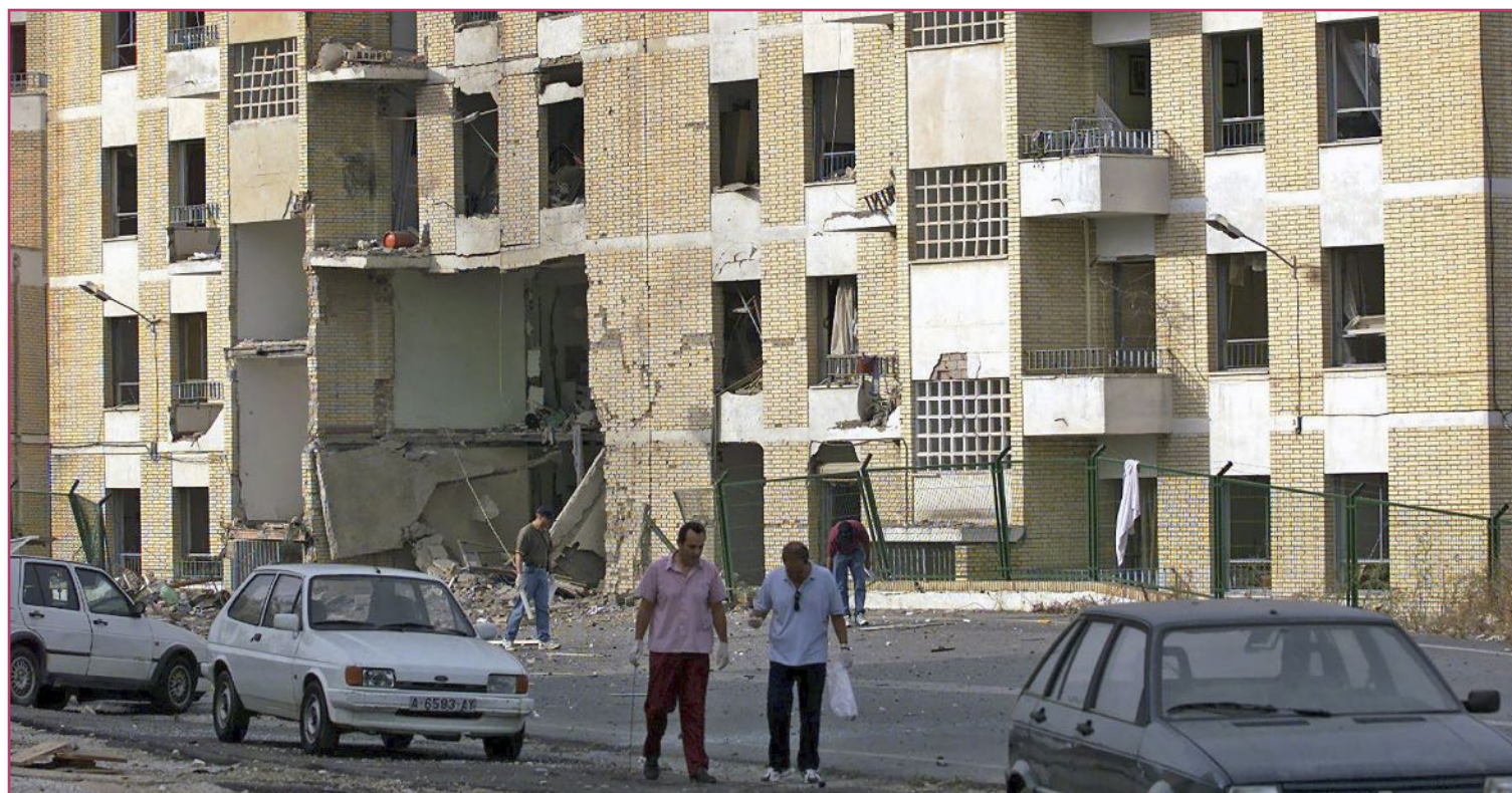
Destrozos causados por la explosión.
