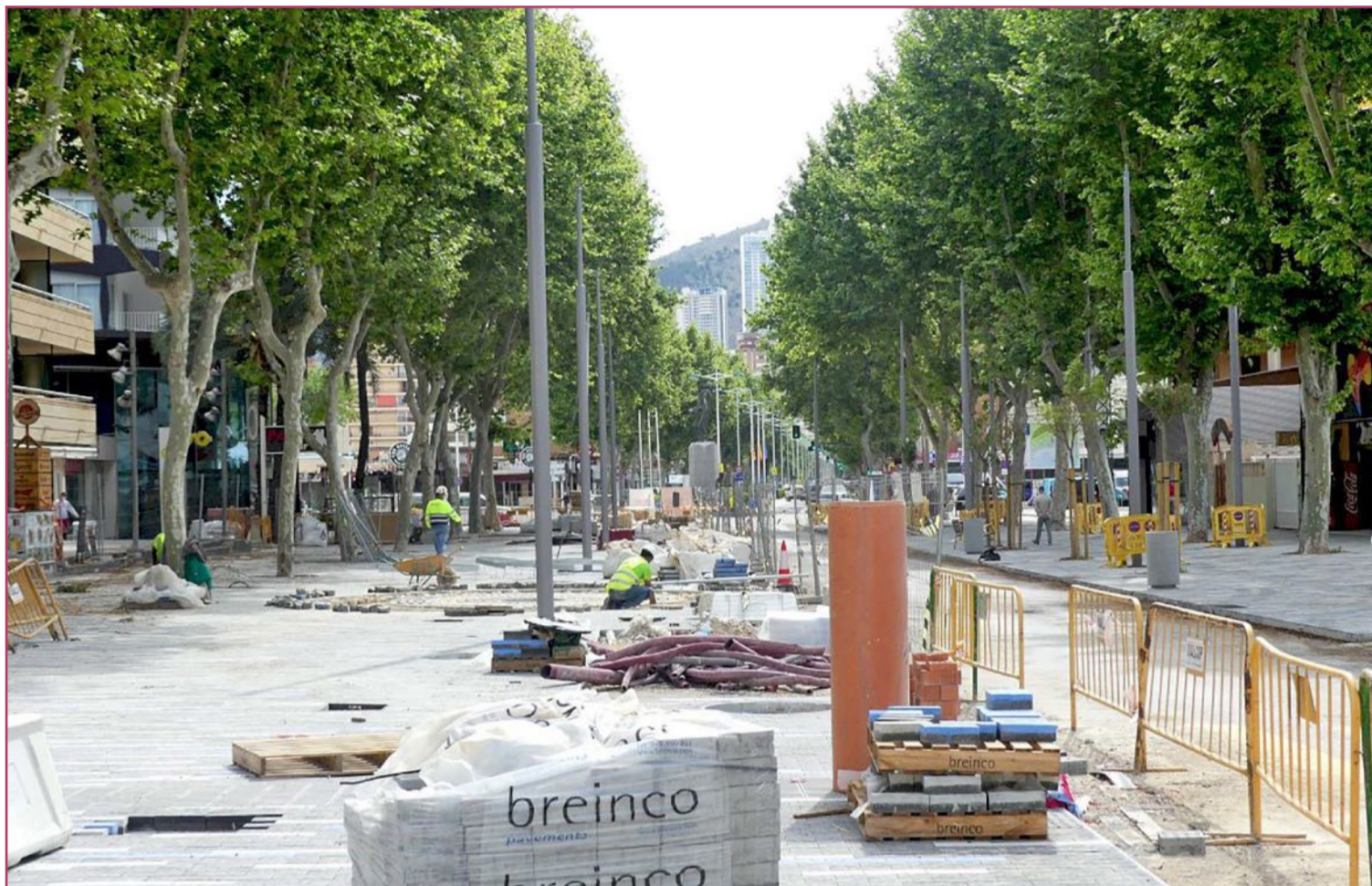
Las obras del Mediterráneo han sido duramente criticadas en el informe afirmando que vulneran la legalidad contractual.
