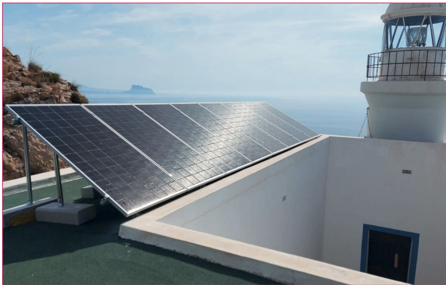
Los espacios públicos también han instalado placas solares.
