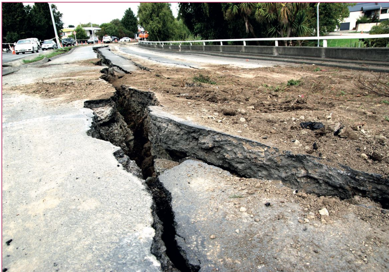
La tierra tiembla, se agrieta, el terremoto campa ya a sus anchas.
