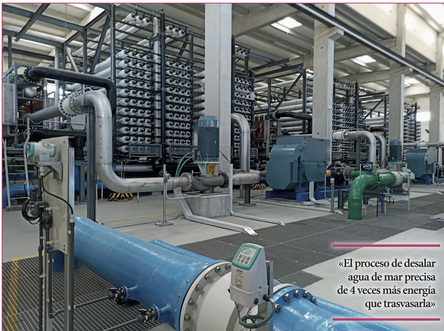
Planta desaladora de Mutxamel.
