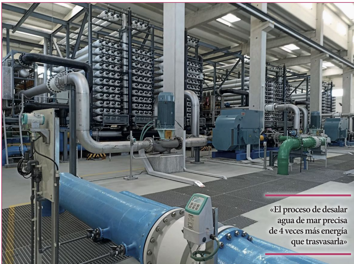
Planta desaladora de Mutxamel.
