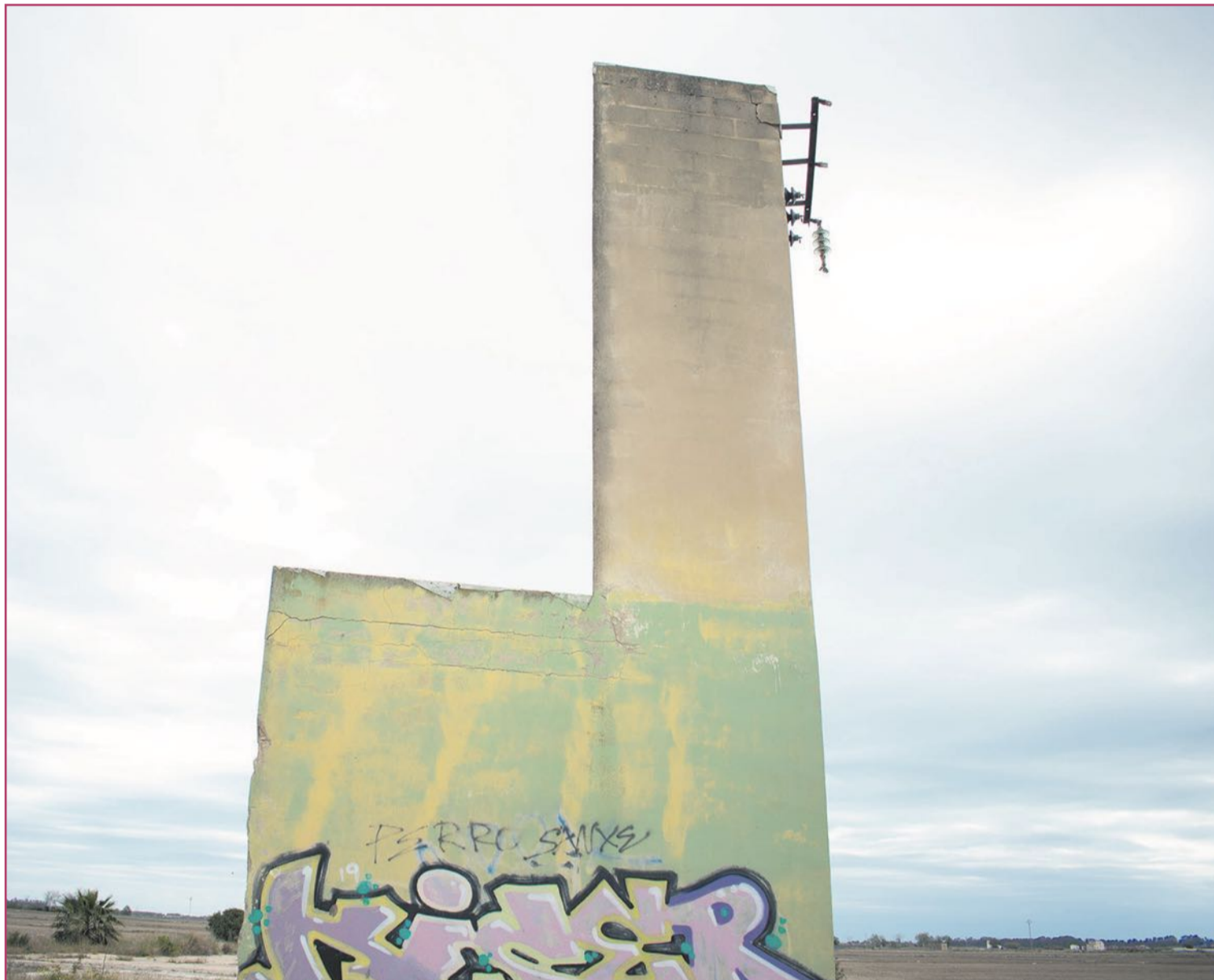
Esto es lo que queda de la torre eléctrica del campo de tiro.
