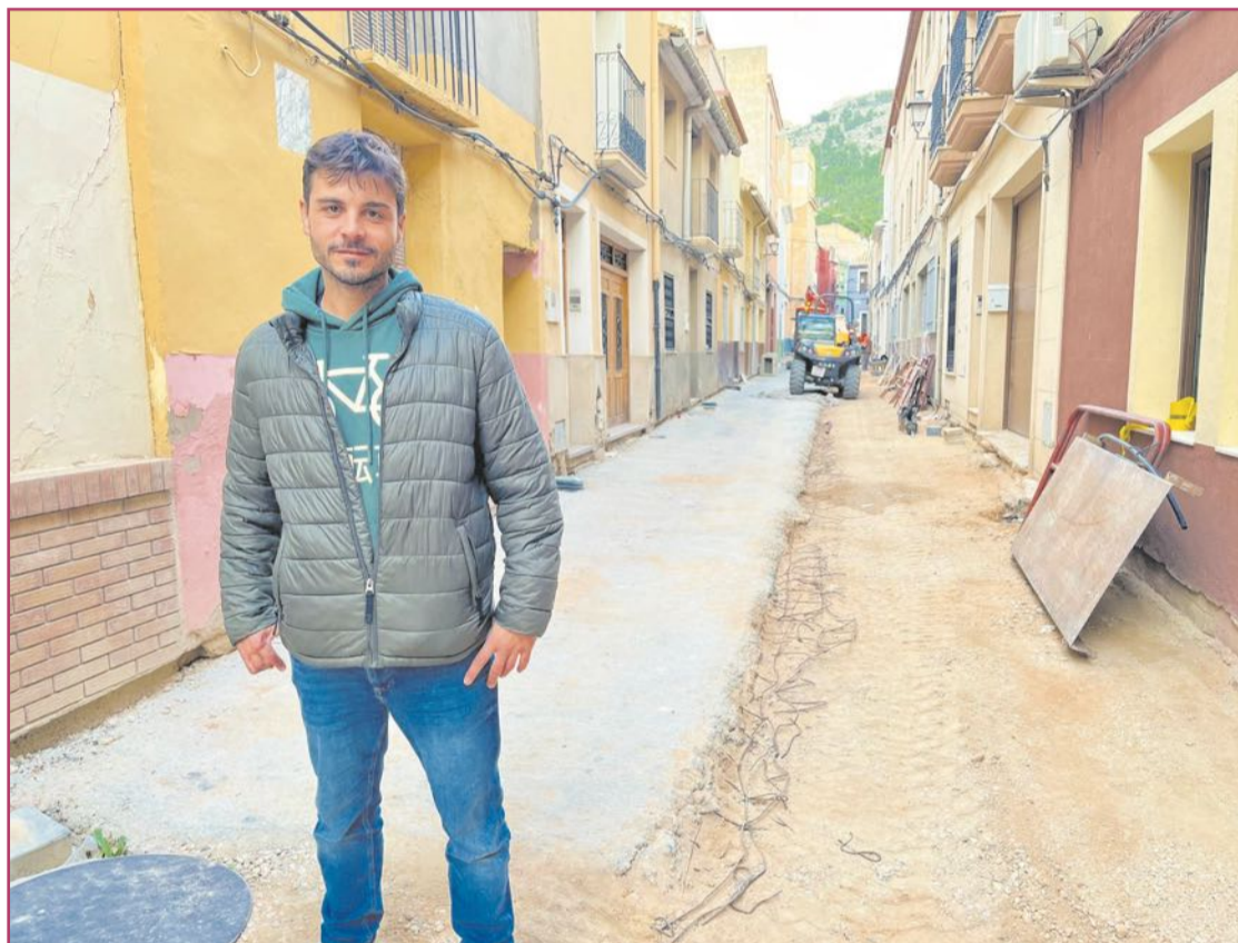
Obras en el entorno de San Antón que propiciaron el descubrimiento arqueológico.
