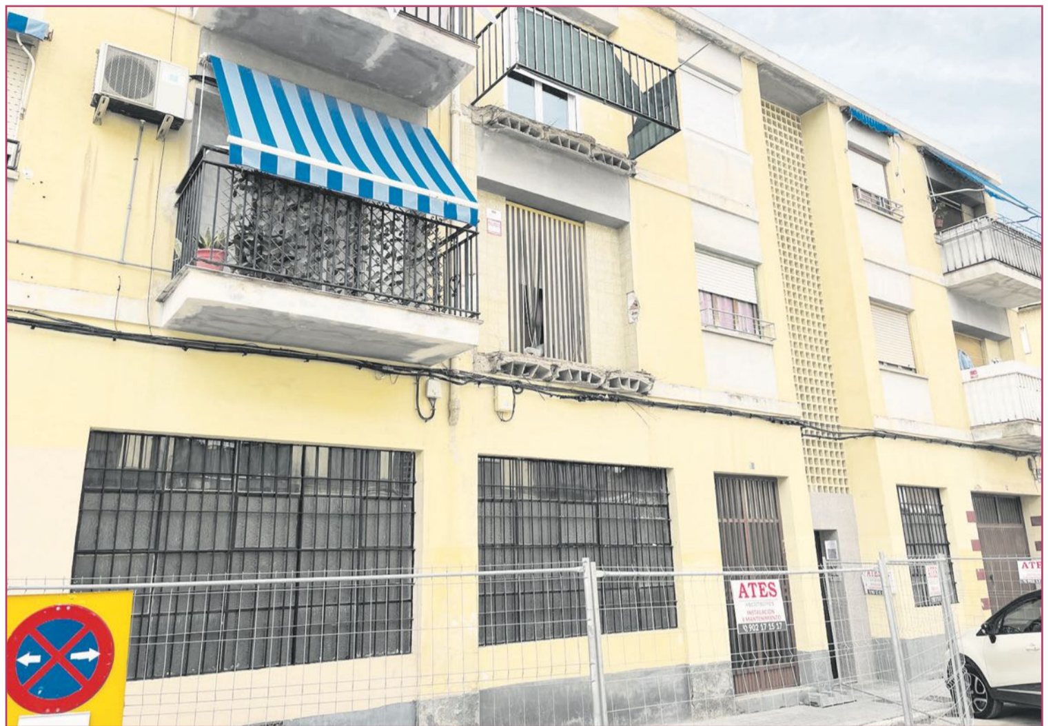
Imagen del piso que ha sufrido el desprendimiento de los dos balcones.
