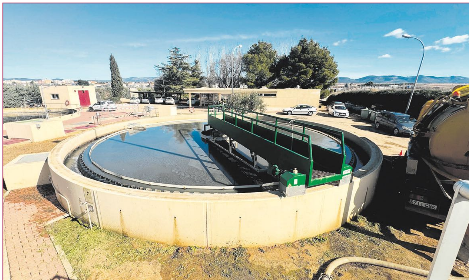
La depuradora sufrió daños como consecuencia de la riada.
